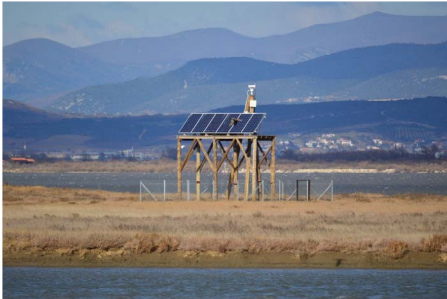
Η Αυτόνομη Απομακρυσμένη Μονάδα του Smart Patrol System στο Δέλτα Έβρου. Διακρίνεται ο οπτικός αισθητήρας και οι φωτοβολταϊκές μονάδες. Φωτ.: Αλεξάνδρα Δεμερτζή/ΟΡΝΙΘΟΛΟΓΙΚΗ
